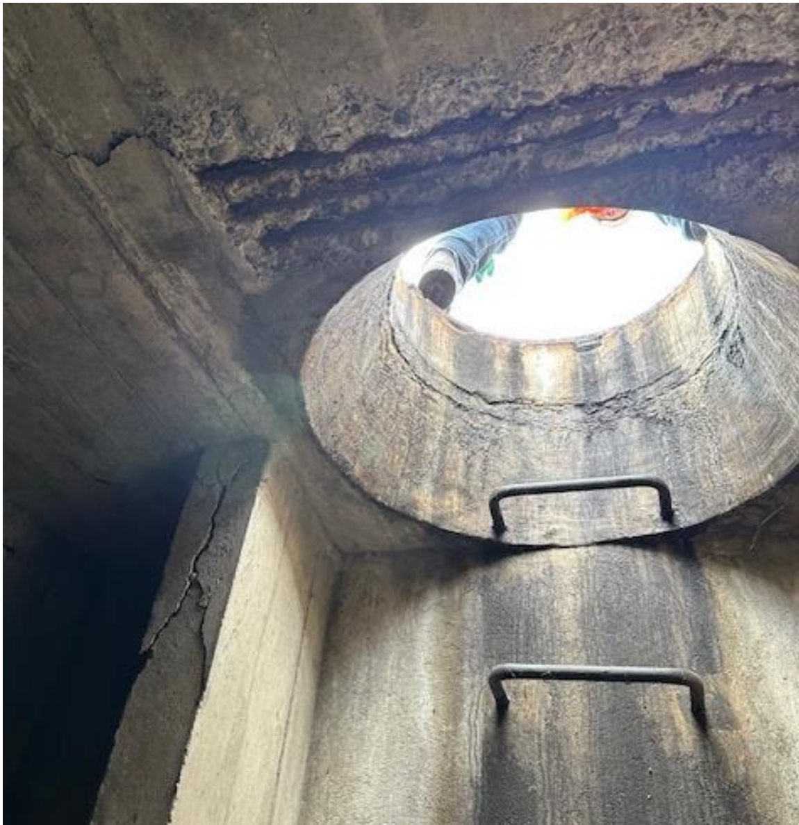
Abbildung 2: Zustand Einstiegschacht zum Regenüberlauf
